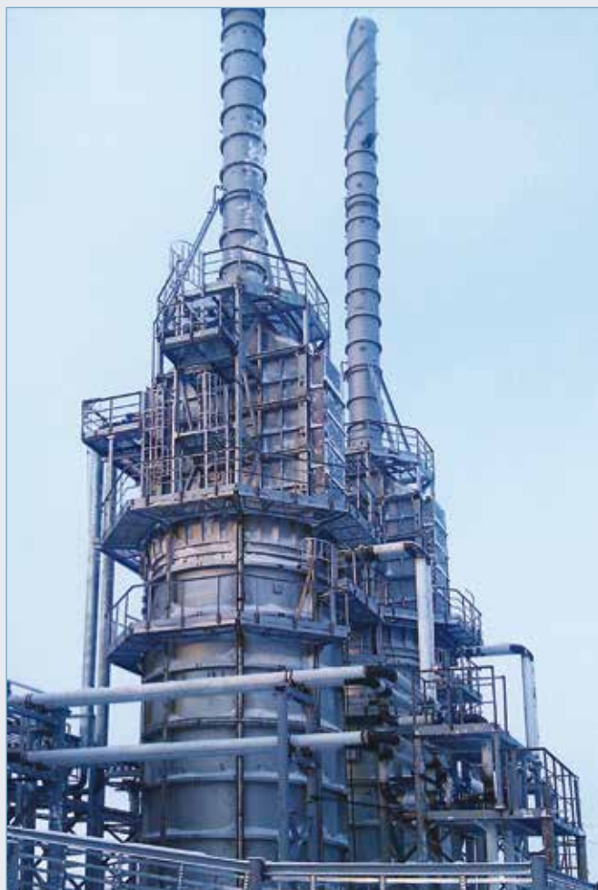
ТНГГ-9-Т105 Печь трубчатая. Общий вид.
