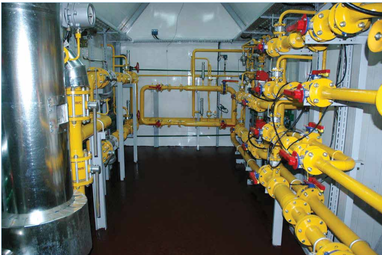
Блок технологический подготовки газа для собственных нужд
