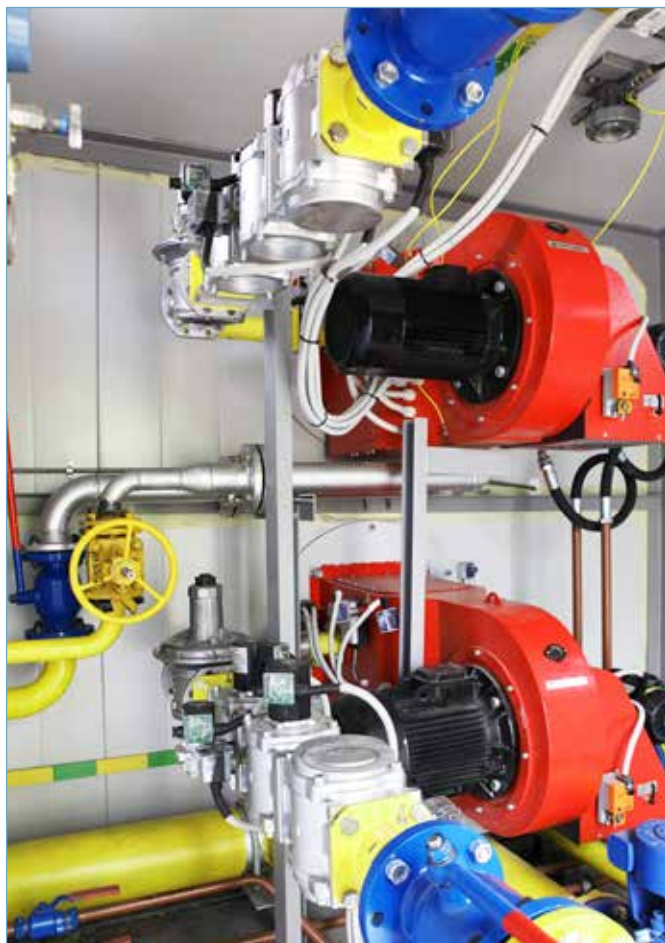
Горелочный отсек камеры сгорания блока термической утилизации
