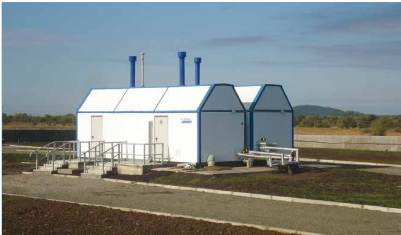
Водопад-30СБ в комплекте с ПВ-20, Дальний Восток
