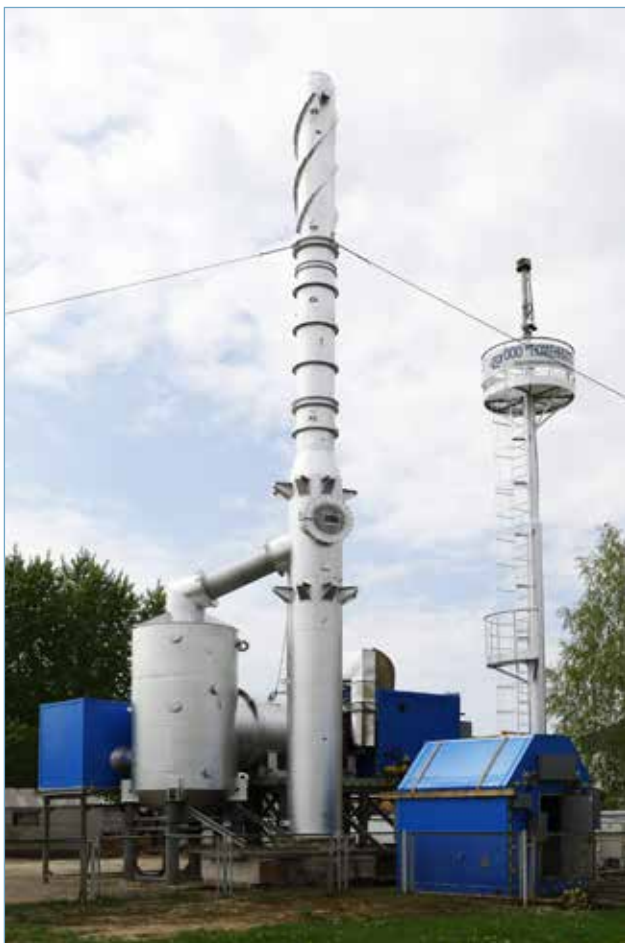
Блок термической утилизации на заводских испытаниях
